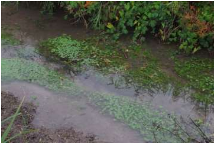
Envasement du lit du à la présence d'un frein aux écoulements
